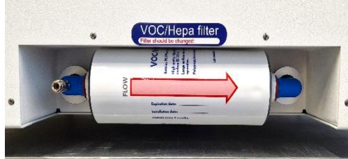
Figura 12.3 Filtro COV/HEPA correctamente instalado
